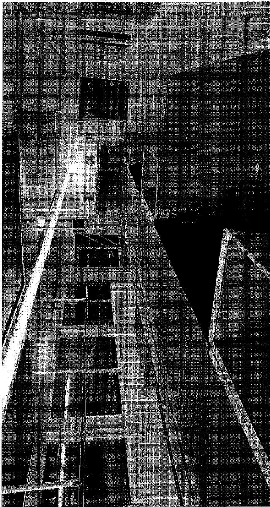
Cabina de sortare cu ventilatie/incalzire
